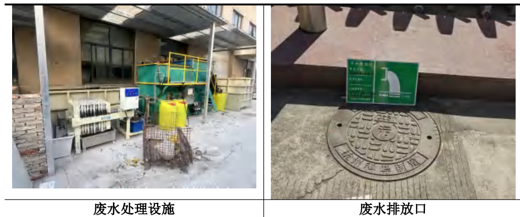
图 3-1 废水处理设施及排放口照片
