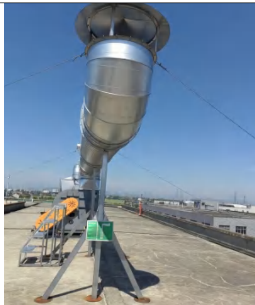
调漆、烘干、浸漆废气出口
